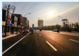
潜江市“城市双修”建设项目—江汉路人行道改造工程 施工单位：天恩建设集团有限公司 监理单位：湖北潜江工程建设项目管理有限公司 彭雨 摄
