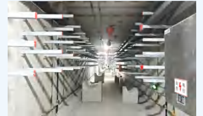
工程名称：点军路（南站路-牌坊坡路）地下综合管廊工程 施工单位：湖北益通建设股份有限公司 监理单位：重庆市工程管理有限公司
